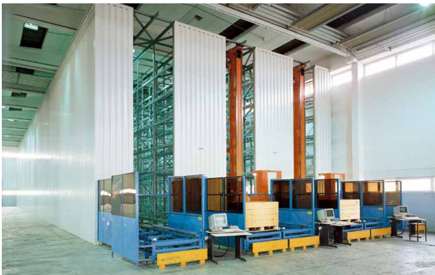
Deposito Portapallet B90/110 per componenti elettrici, servito da transloelevatori
